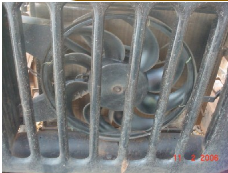
Ventoinha que empurra o ar geralmente de ar condicionado.
